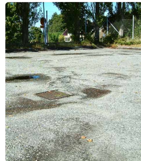
Det blir ofta sättningar runt rännstensbrunnar.
